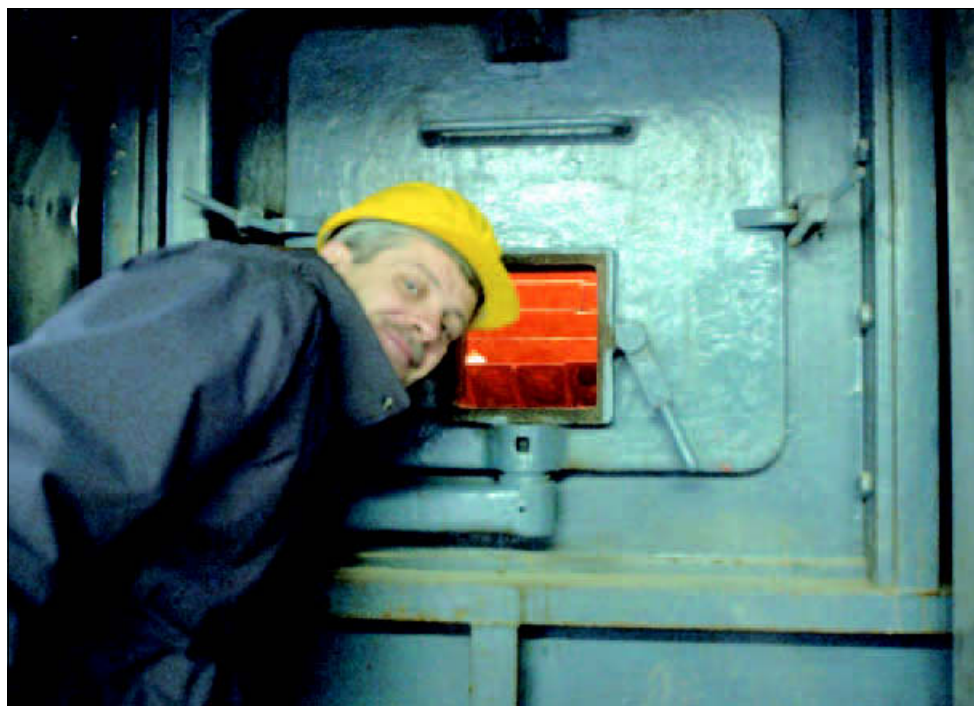
Un'immagine dell'interno dell'inceneritore di Cavazzoli scattata dopo la ristrutturazione
